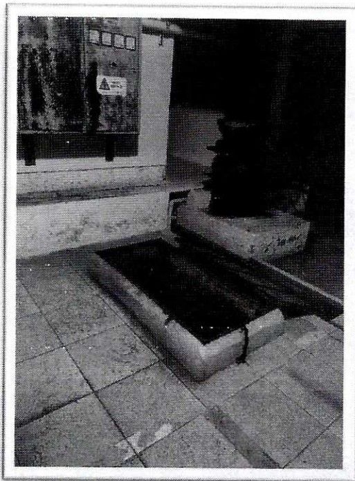
Foto N° 17. Punto de Muestreo Salida Filtrada PTAP 1500
