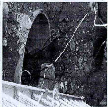
entrada de conexión
