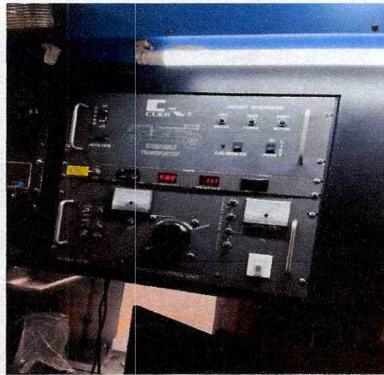
Figura NO.32 Revisión y mantenimiento consolas
