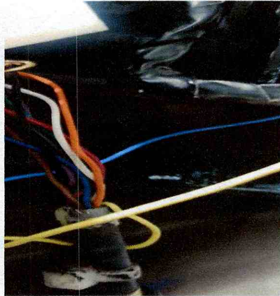
Figura NO.14 revisión cableado equipo de inspección
