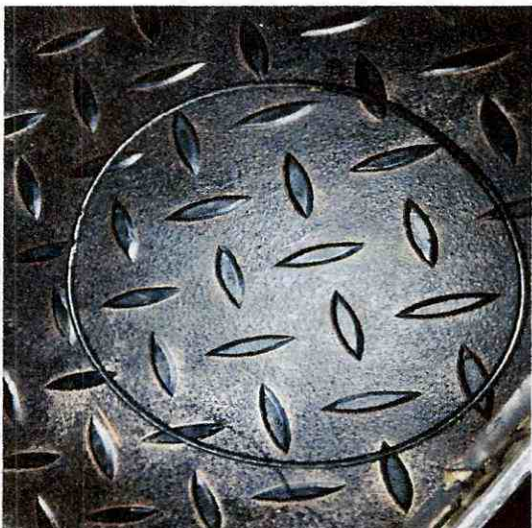
Figura NO.11 Oring dañado de tapa trasera
