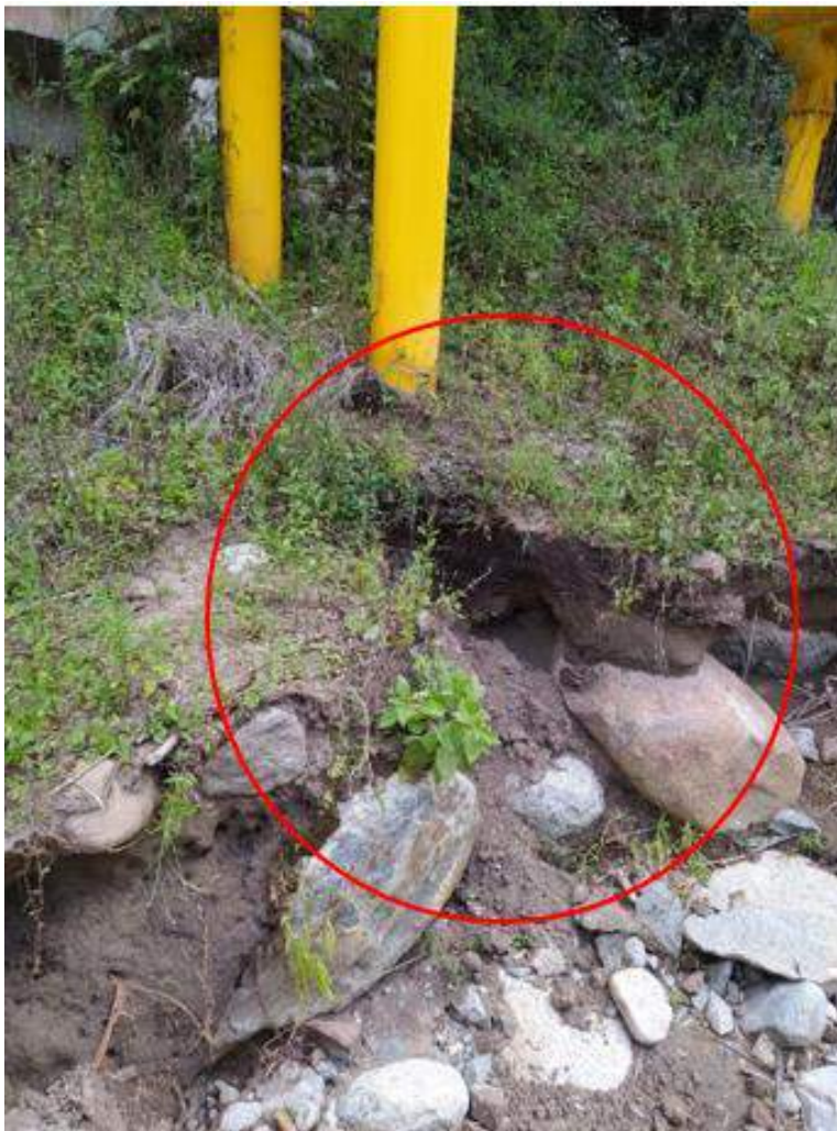
Ilustración 8-6 Erosión de marcos H
