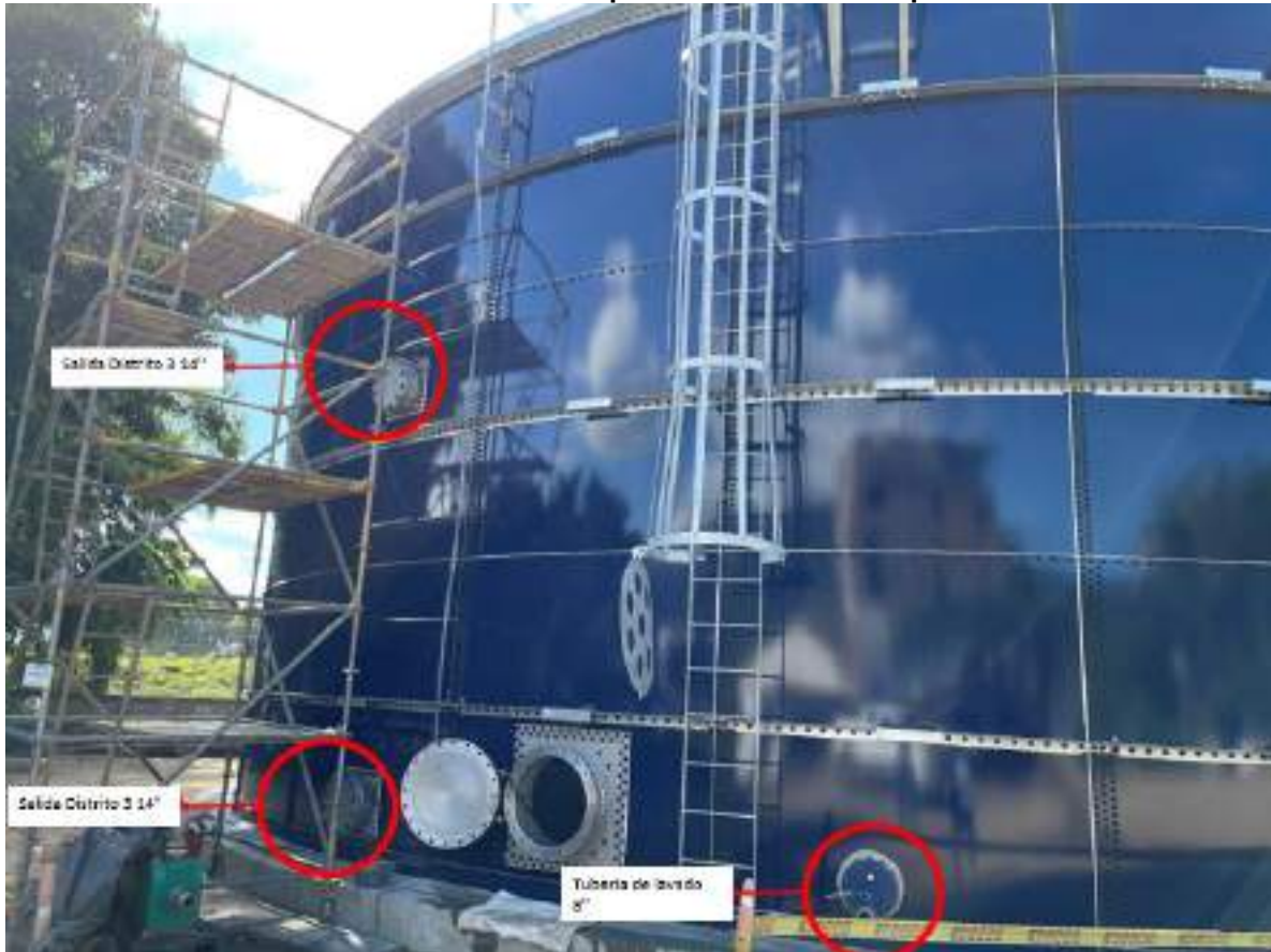
Ilustración 5-10 Tanque sur- Salida de campo
