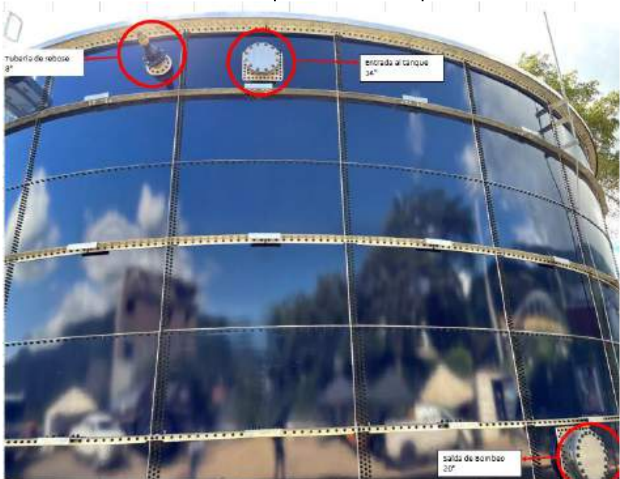
Ilustración 5-11 Tanque Sur – Salida de Campo
