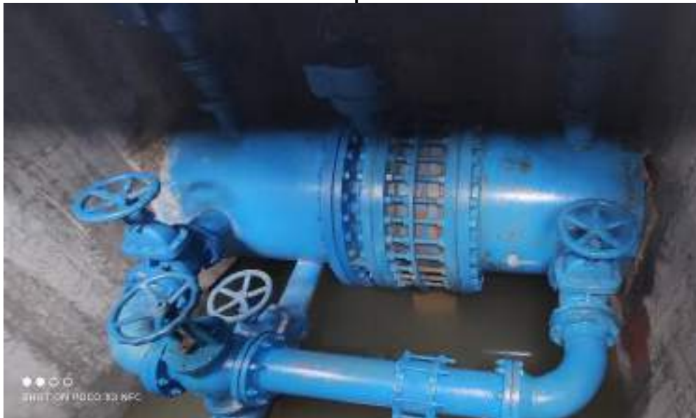
Ilustración 5-1 Válvula Principal red Aducción- Recorrido
