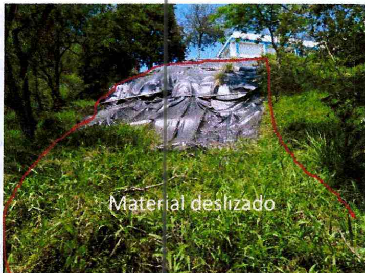
Ilustración 6-1. Ladera nororiental afectada por un deslizamiento tipo flujo de tierras.
