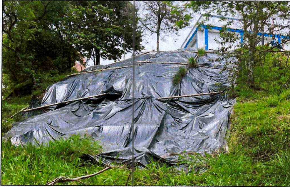
Ilustración 3-2. Deslizamiento en el predio del Tanque Piedra Pintada.
