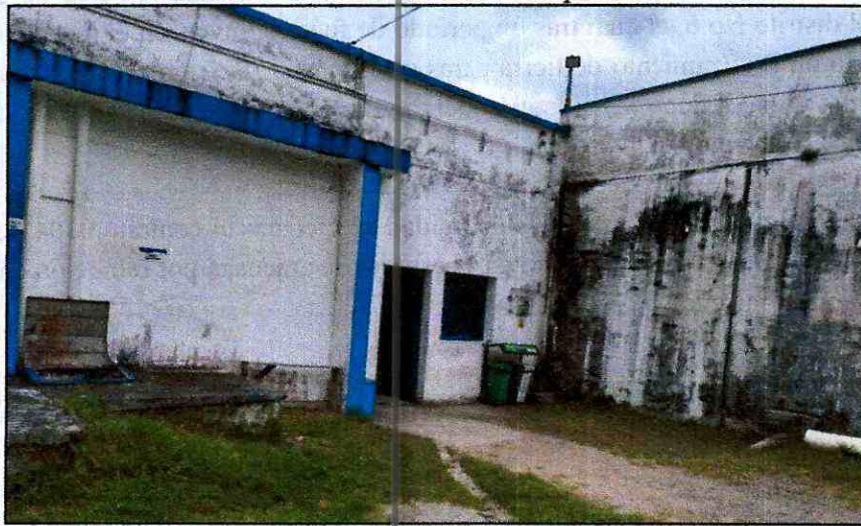
Ilustración 5-1. Estructuras del Tanque Piedra Pintada.
