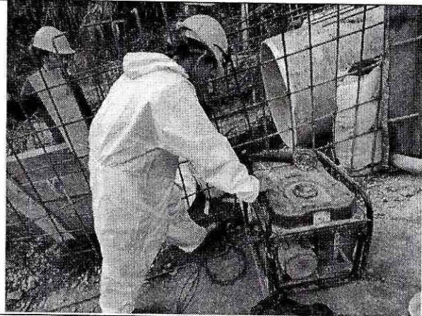
Planta sin contención de derrames de combustible
