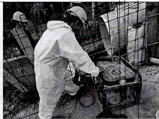
Planta sin contención de derrames de combustible
