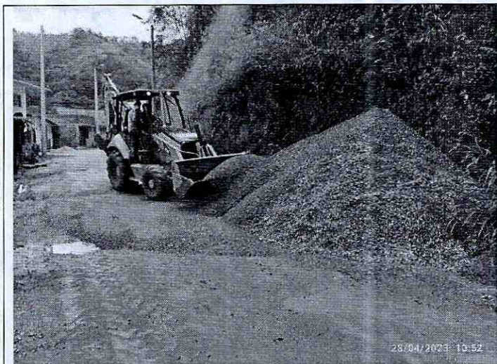
DESCRIPCION: Varios tramos del proyecto se desarrollan sobre la vía, pero no se evidencia personal para el control de la misma.
