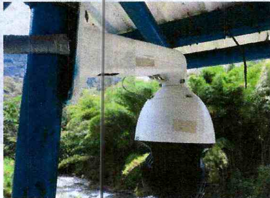
Verificación estado del cableado de comunicación, el cual se observa en perfecto estado y correcto funcionamiento
