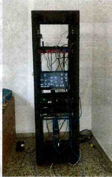
REFRIGERACION FORZADA (antes)
