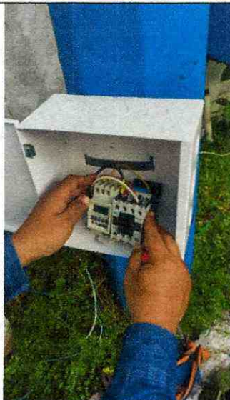
Cambio de fotocontrol en porteria
