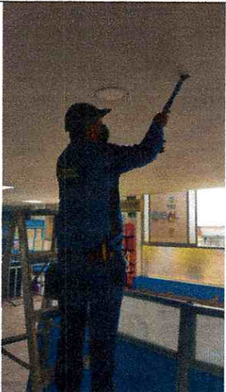
Desconexión de puntos en oficina de la 15
