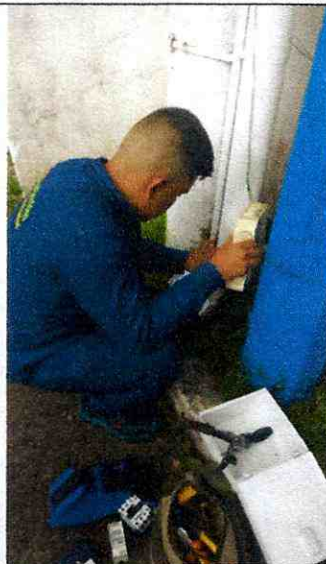
Cambio de fotocontrol en porteria
