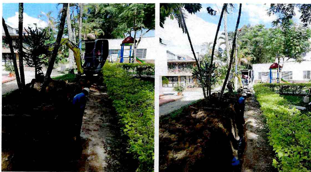
Excavaciones a máquina y excavaciones a mano para el cambio de la tubería de 3" PVC RDE 21 con la instalación de la domiciliaria del salón comunal del barrio San Luis Gonzaga.
