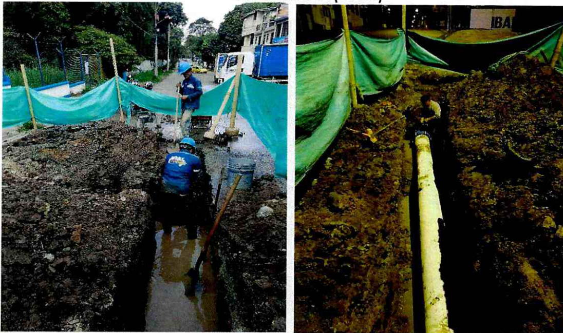
Reposición de 6 metros de tubería de 12" pulgadas en la red de conducción del tanque la 30 al tanque de Piedra Pintada daño solucionada sobre la cra 4H con calle 30
