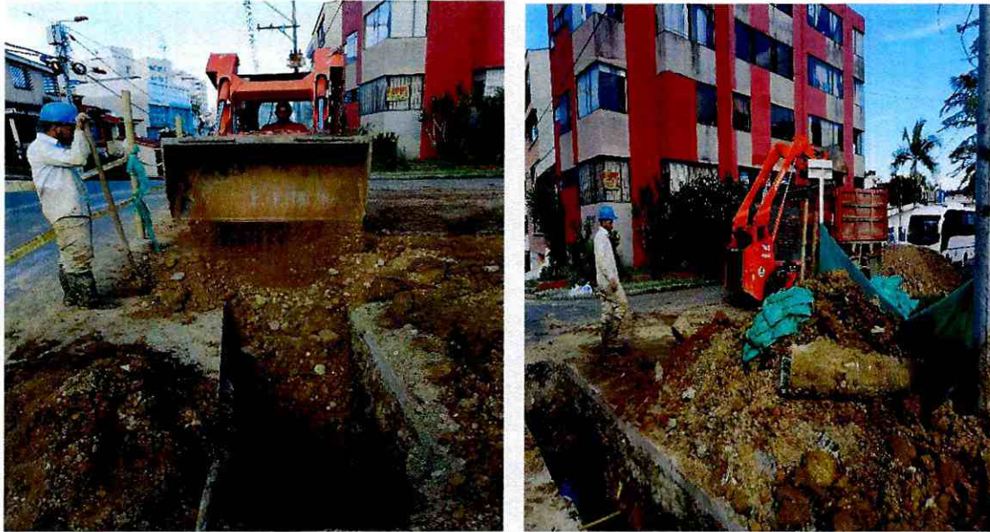
Suministro del material de recebo para el lleno de las excavaciones y retiro del material sobrante proveniente de las excavaciones a la escombrera
