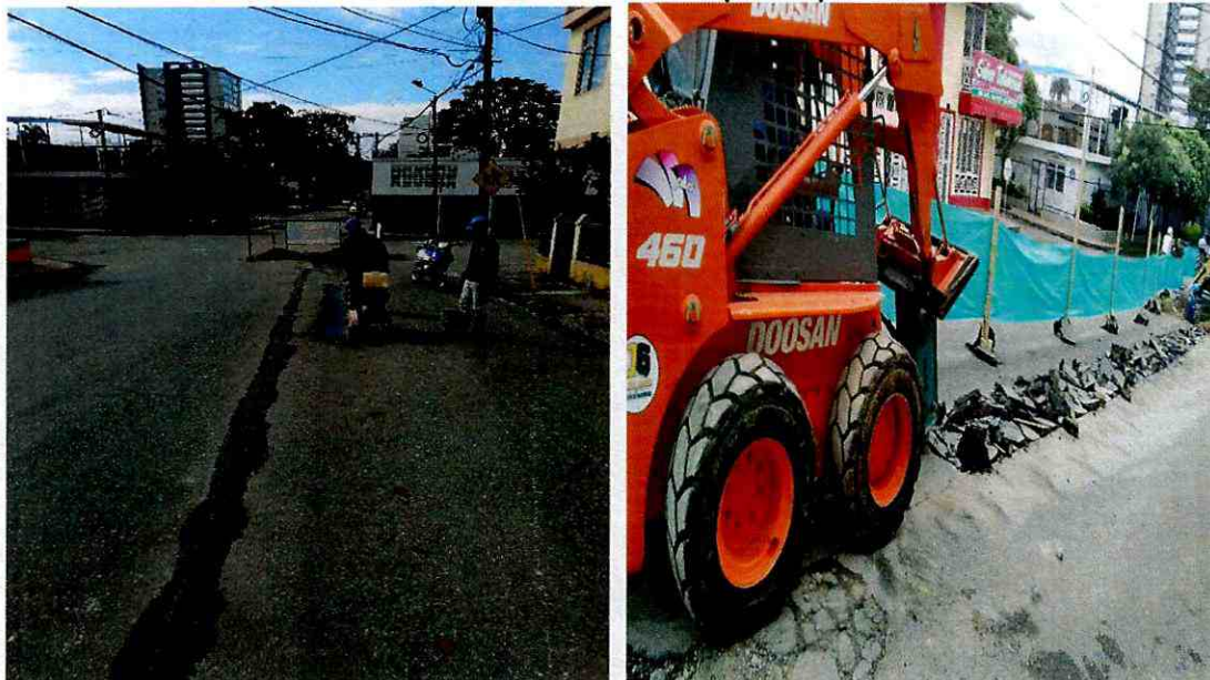
Corte con cortadora de la carpeta asfáltica y demolición del asfalto para poder realizar las excavaciones sobre la red de conducción de 12" pulgadas sobre la carrera 4H entre calles 38 y 39 del barrio Magisterio
