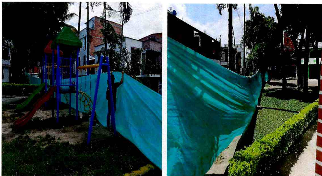
Instalación de la poli sombra para el cerramiento de las excavaciones y evitar que los habitantes del sector entren a las excavaciones y de esta manera prevenir accidentes.
