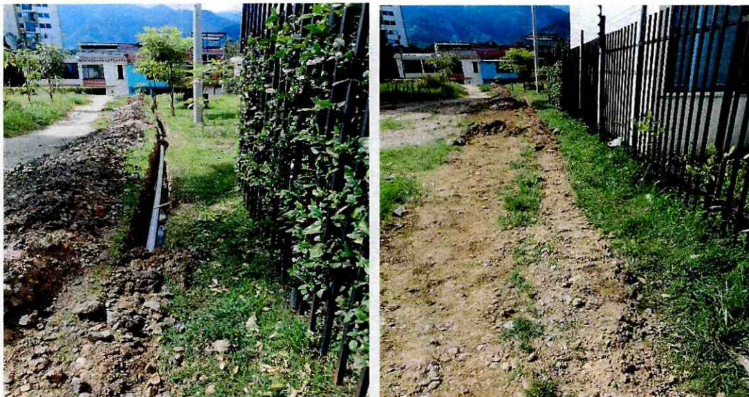
Llenos con material de las mismas excavaciones para tapar la tubería de 3 pulgadas PVC presión que se instaló en una zona peatonal para el mejoramiento de la presión de la red existente en el barrio el limon.
