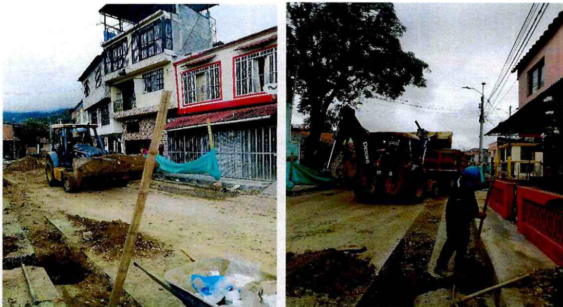
Retiro del material de las excavaciones a la escombrera autorizada por el municipio ya que los llenos se realizaron con material de recebo compactado.
