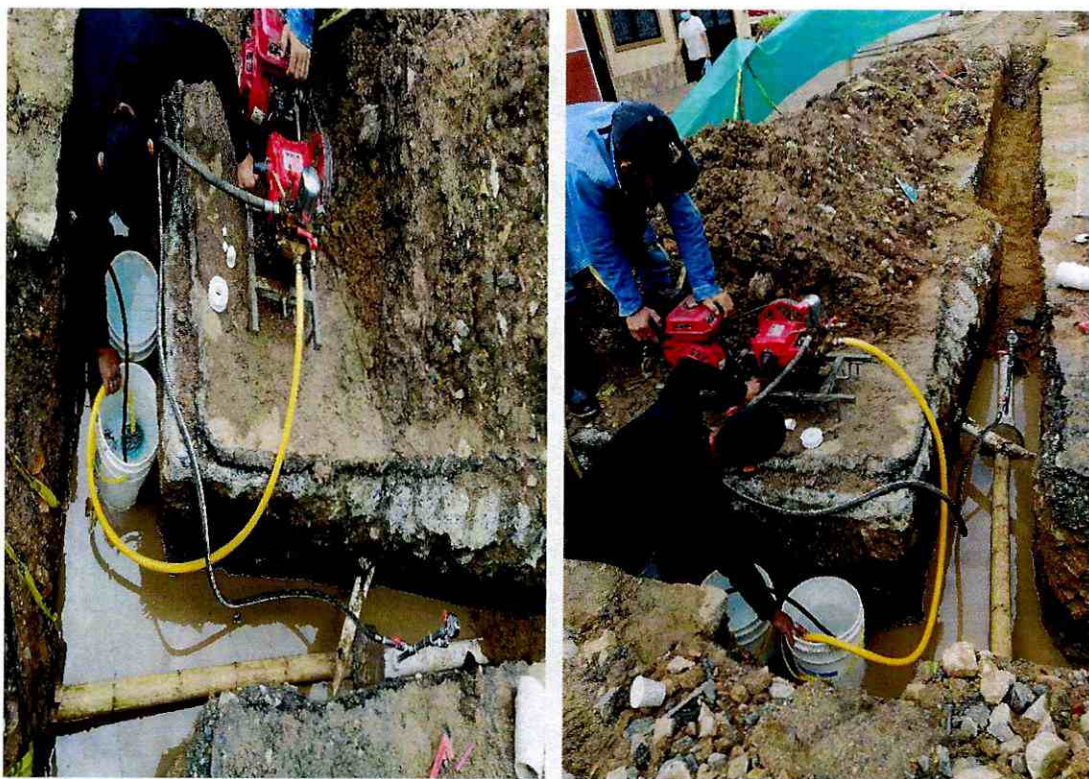
Prueba de presión a la tubería para la verificación de su estado y que no presente fugas para su posterior puesta en uso para la comunidad.
