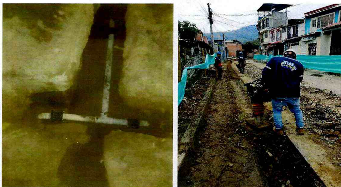
Instalacion universales de 3" con sus respectivos empalmes y compactación mecánica con canguro del material de recebo para le lleno de las excavaciones de la red principal de acueducto y las domiciliarias.
