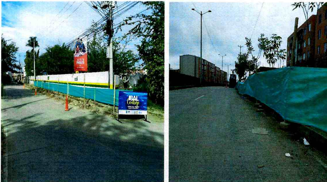
Cerramiento con poli sombra a lo largo de las excavaciones para la instalación de la tubería PVC presión de 6" pulgadas para mejorar el servicio de algunos conjuntos en el sector de la Arboleda Campestre.
