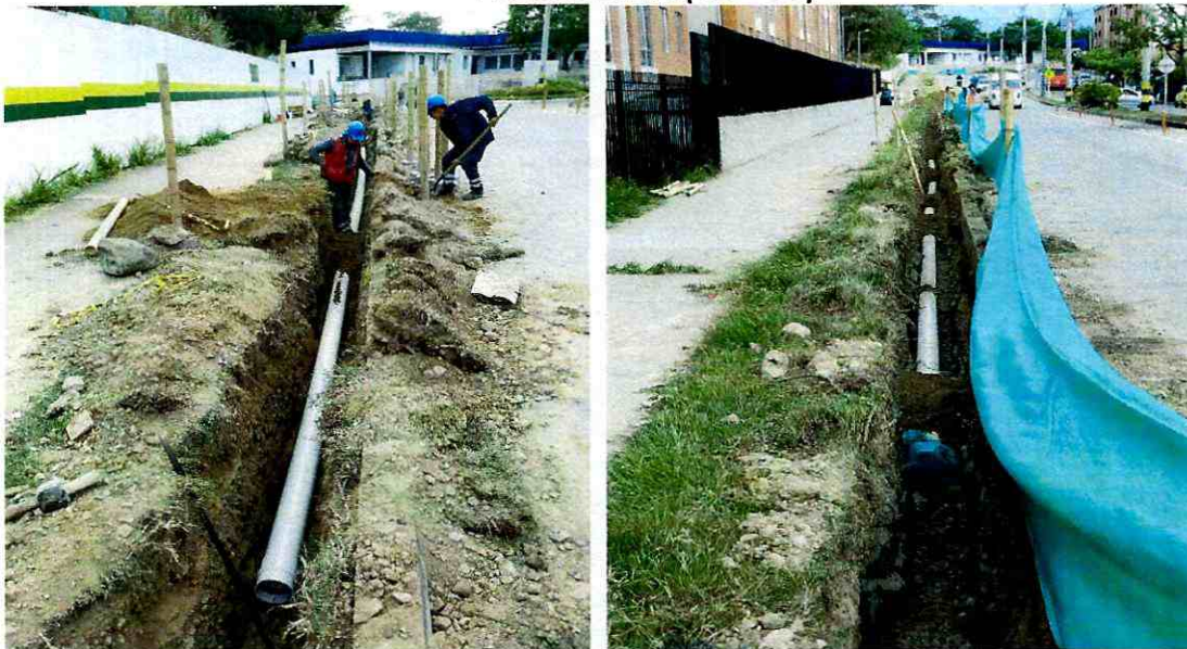
Suministro e instalación de la tubería PVC presión de 6" pulgadas con unión mecánica a lo largo del tramo de la Arboleda Campestre para el mejoramiento del servicio de acueducto en el sector
