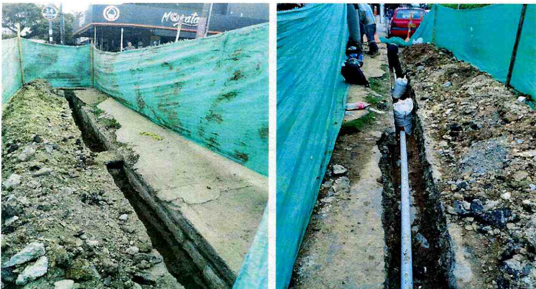
Demolición de asfalto, excavaciones a mano, instalación de tubería de 2" y 3" pulgadas para el mejoramiento del servicio de algunas viviendas en el barrio San Pablo.
