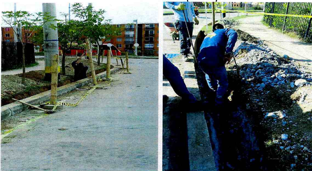
Excavaciones a mano y demoliciones de concreto reforzado que se encontraron en diferentes sectores de las excavaciones debajo del a zona verde y retiro del material sobrante con los escombros de las demoliciones.
