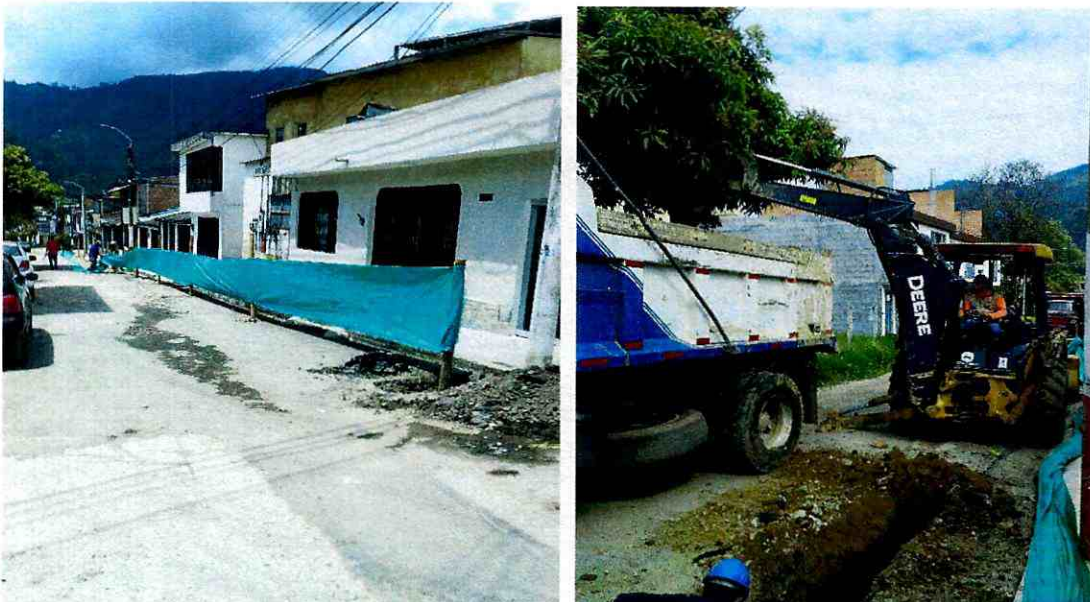
Cerramiento en poli sombra, y excavaciones a máquina para el cambio de la red principal que se encuentra en asbesto cemento por tubería PVC presión de 3" pulgadas, profundizarla ya que se encontraba superficial en el barrio Villa Luces.
