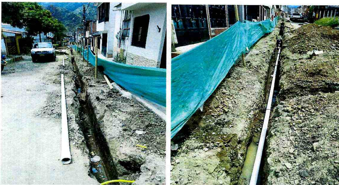
Suministro e instalación de la tubería PVC presión de 3" pulgadas para el cambio de la red matriz que se encontraba en asbesto cemento y profundización de misma en el barrio Villa Luces del sector del Ricaurte.
