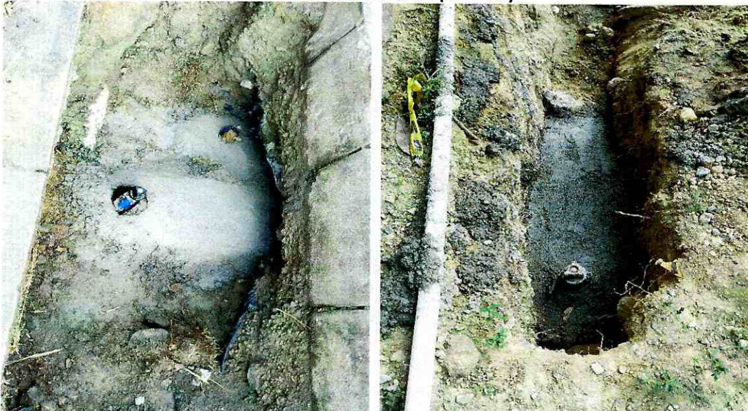
Suministro e instalación de concreto de 3.000 PSI para el atraque de alguno accesorios y válvulas instaladas a lo largo de toda la tubería PVC presión de 6" instalada en el sector la Arboleda Campestre.
