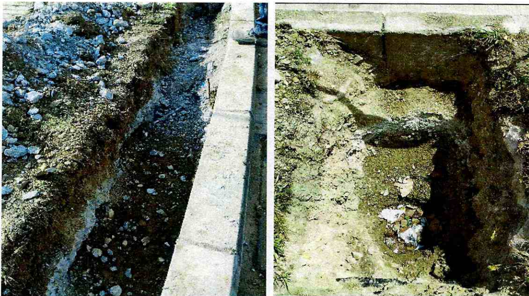
Demoliciones de concretos reforzados existentes debajo de la zona verde sobre las excavaciones realizadas para la instalación de la tubería de 6" pulgadas.
