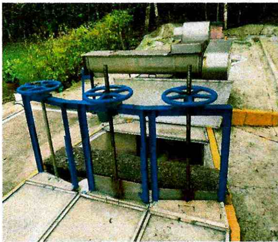
Figura 3. Sistema de compuertas.
