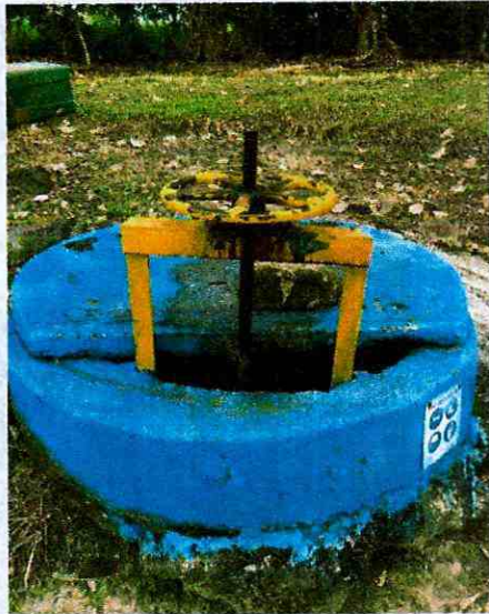
Figura 5. Sistema de Compuertas.
