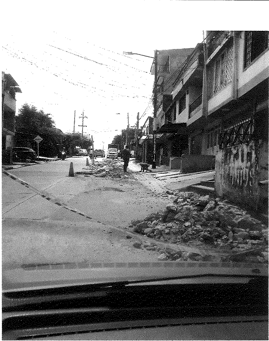
Rotura de pavimento rigido (CALLE 44 ENTRE 6TA Y 7MA)
