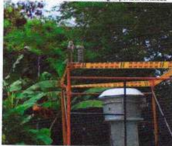
Fotografía 6.1 Estación meteorológica portátil instalada
