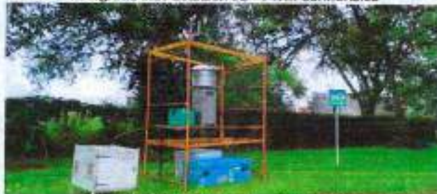
Fotografía 5.17 Estación 02 – PTAR Comfenalco
