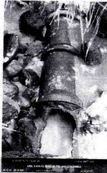
Imagen 6. Daño a la tubería. Fuente: IBAL S.A. E.S.P. Oficial
