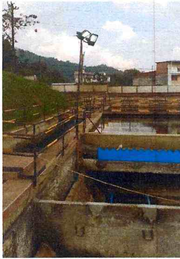
Sistema de iluminaziom
