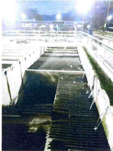
Fotografía del sedimentador sin tubería recolector (extraída) u tela se asbesto cementoa retirar.
