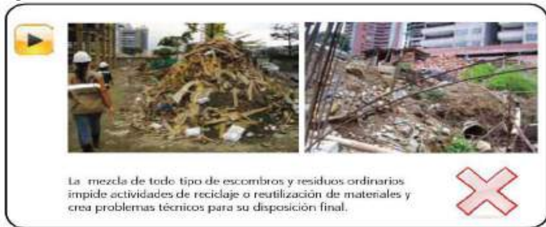
Figura 6. Inadecuada clasificación de residuos
