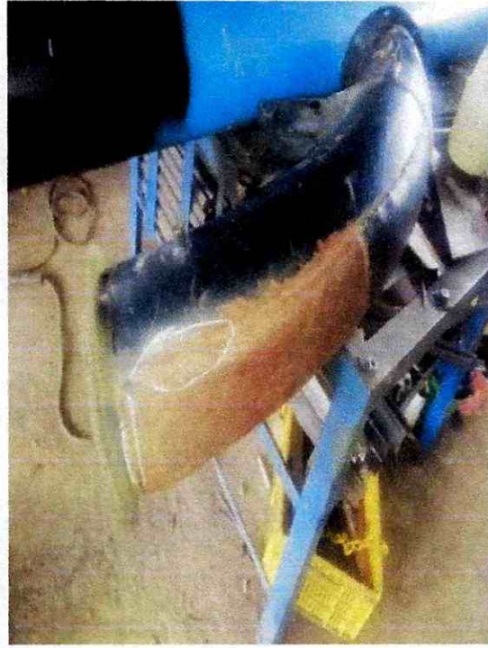
FIGURA 18. DESMONTAJE DE CODO DE SUCCION POR FUGAS
