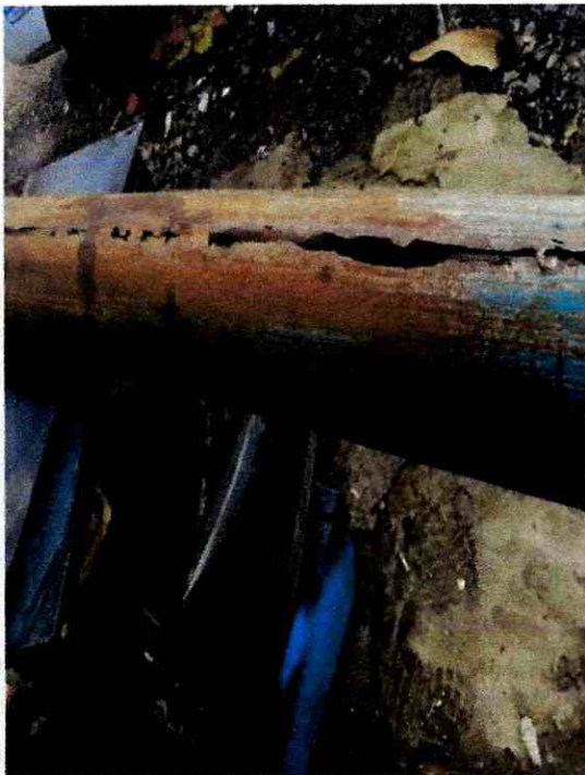
FIGURA 17. TUBO INTERNO CON EROSION Y HUECO
