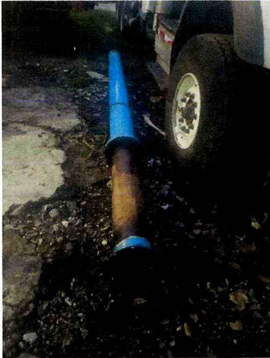
FIGURA 17. DESMONTE DE TUBOS INTERNO Y EXTERNO POR FUGAS
