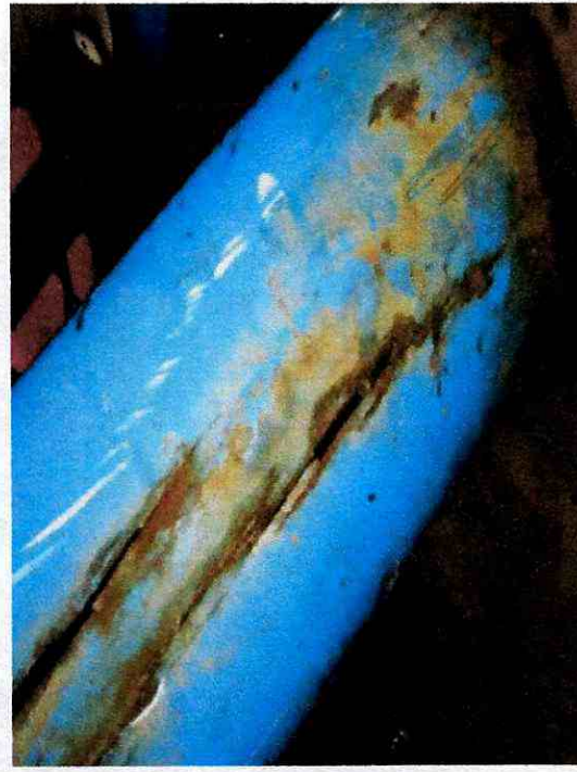
FIGURA 18. TUBO EXTERNO EROSIONADO
