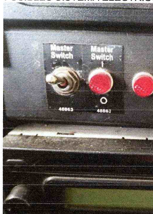
FIGURA 4. REVISIÓN TÉCNICA SISTEMA ELECTRICO
