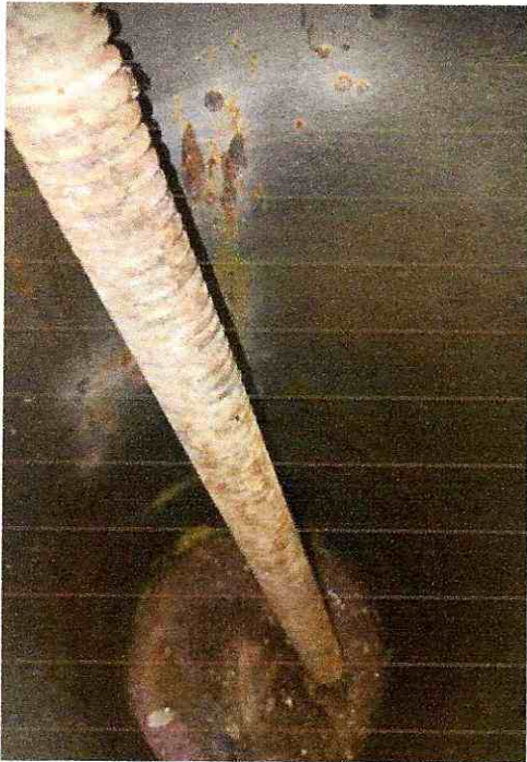
FIGURA 55. Revisión y desmontaje bomba de agua, camisa de agua picada
