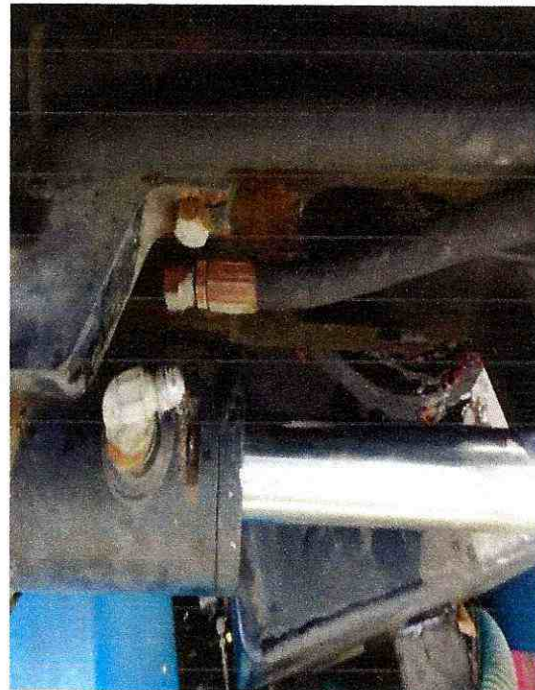
FIGURA 2. DESMONTE DE CILINDRO HIDRAULICO LEVANTE BOOM CON FUGA
