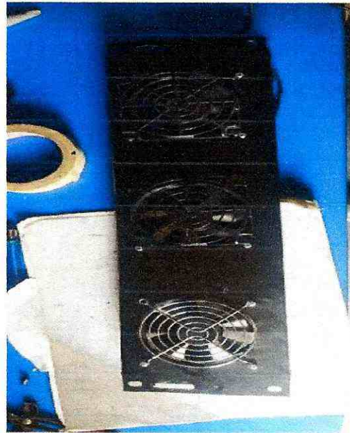
FIGURA 10. MANTENIMIENTO EQUIPOS ELECTRONICOS
