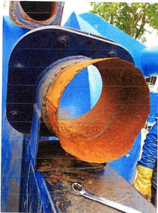
FIGURA 9. ducto de soporte delantero erosionado
