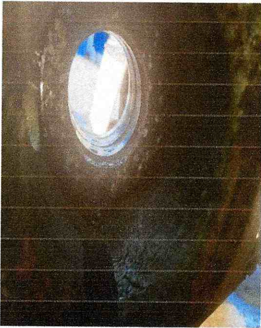
FIGURA 53. Erosión interna bomba de agua
