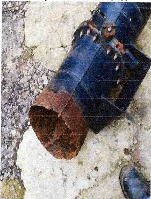
FIGURA 7. Ducto alivio erosionado
