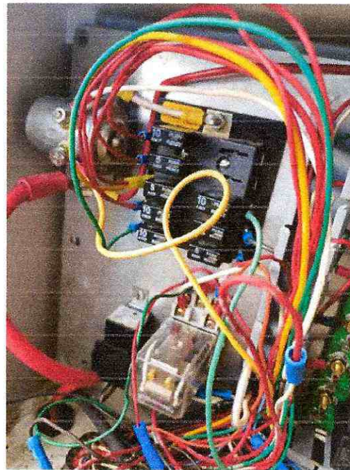
FIGURA 2. REVISIÓN TÉCNICA FUSIBLES SISTEMA ELECTRICO
