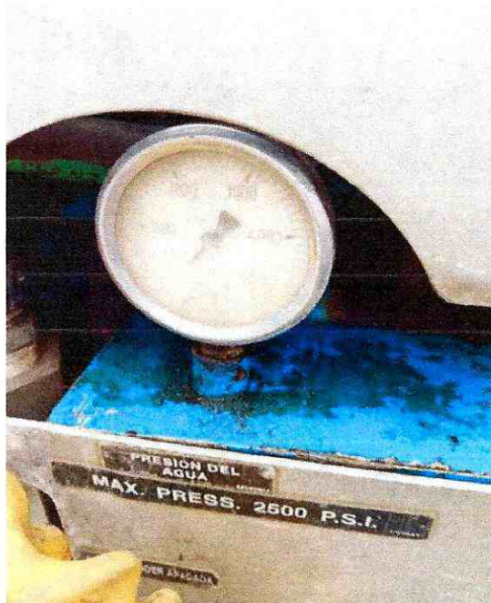
FIGURA 25. MANOMETRO DE PRESION EN MAL ESTADO
