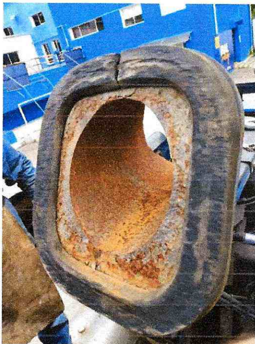
FIGURA 43. Sello entre tanque y ducto de succión en mal estado
