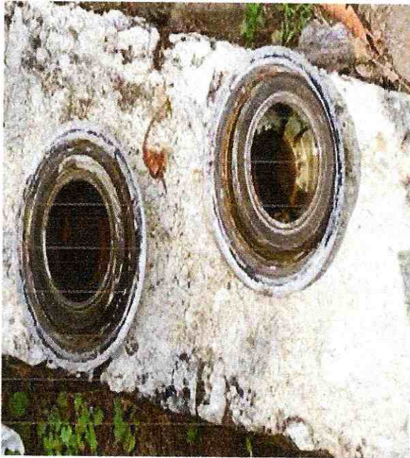
FIGURA 57. Válvula de retención de 3" erosionadas con pérdida de material
