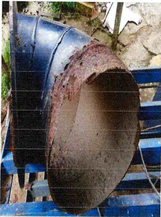
FIGURA 5. Ducto en Codo erosionada con perdida de material
