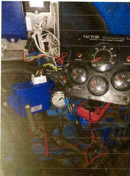
FIGURA 15. Revisión técnica módulos de control, indicadores de medición
