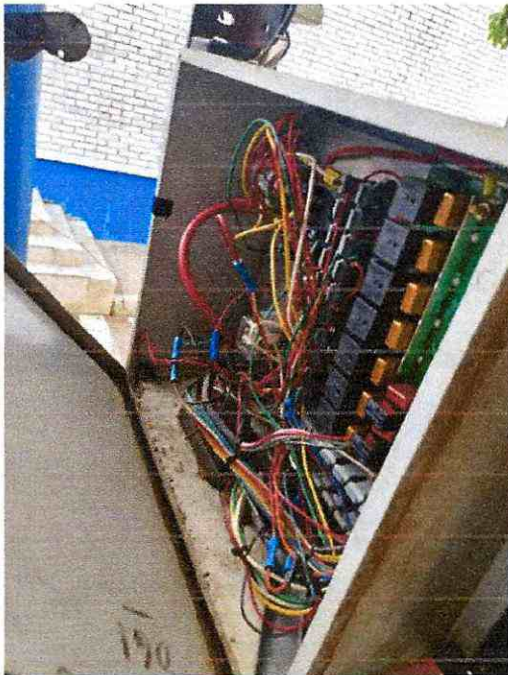
FIGURA 5. REVISIÓN TÉCNICA ELIMINACION CORTO ELECTRICO
