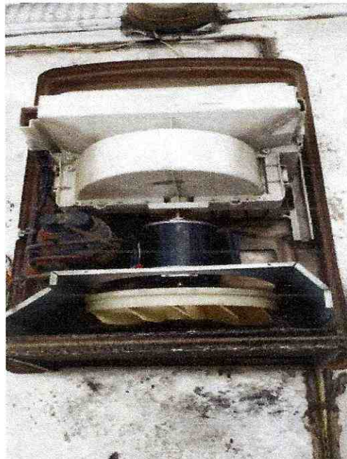
FIGURA 2. DESARME AIRE ACONDICIONADO
