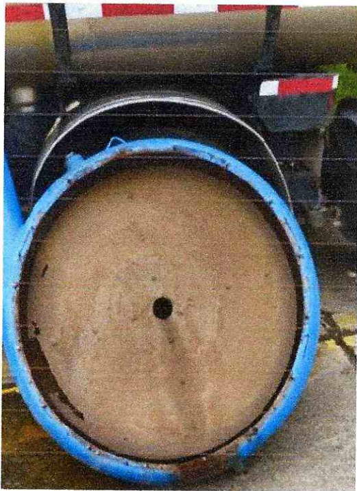
FIGURA 37. Desmontaje carcasa con espaciador erosionado
