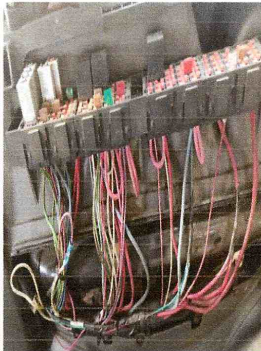
FIGURA 6. REVISIÓN TÉCNICA SISTEMA ELECTRICO
