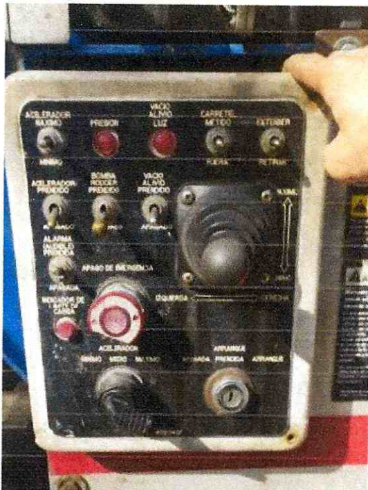
FIGURA 13. Panel frontal switch arranque motor auxiliar en mal estado
