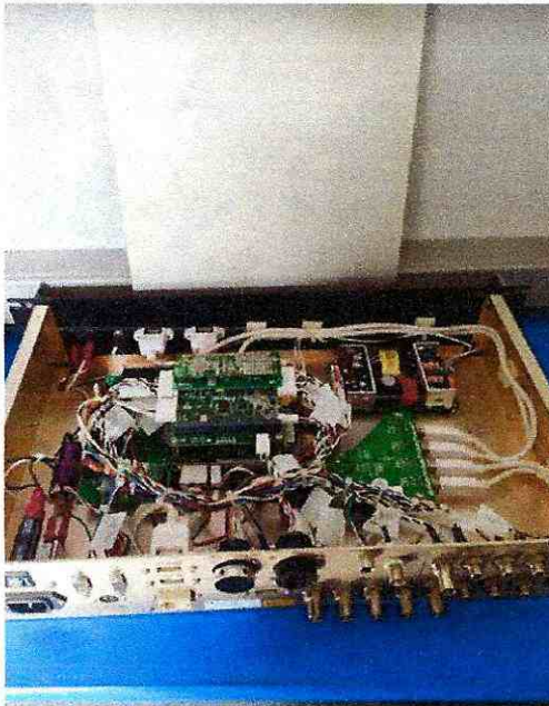
FIGURA 15. MANTENIMIENTO EQUIPOS ELECTRONICOS
