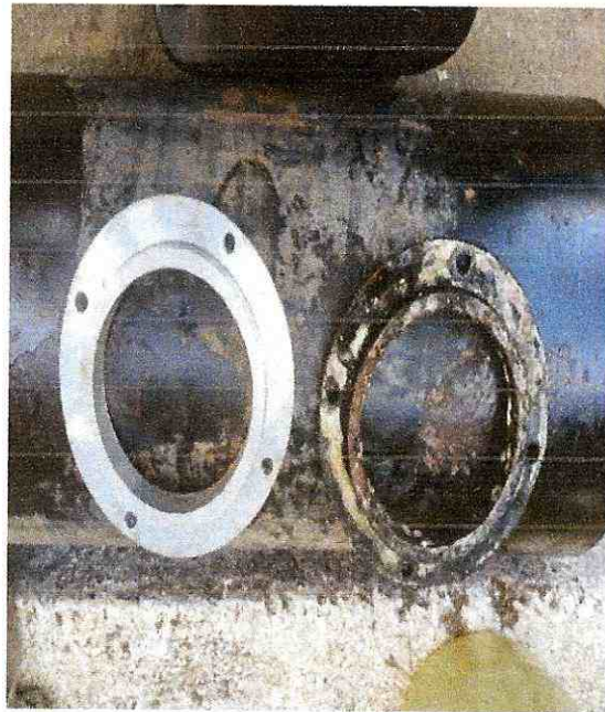
FIGURA 54. Anillo erosionado y anillo nuevo
