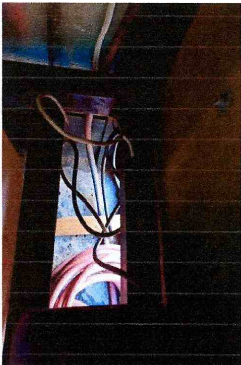
FIGURA 3. REVISION CABLEADO BOMBA DE AGUA
