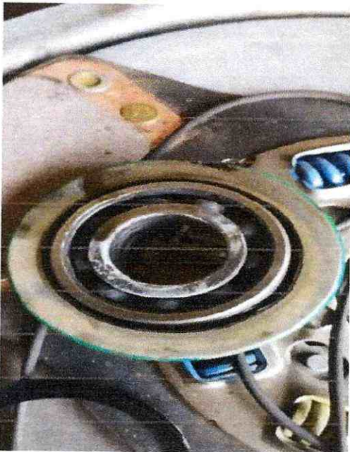
FIGURA 33. Rodamientos y sellos con deterioro interno
