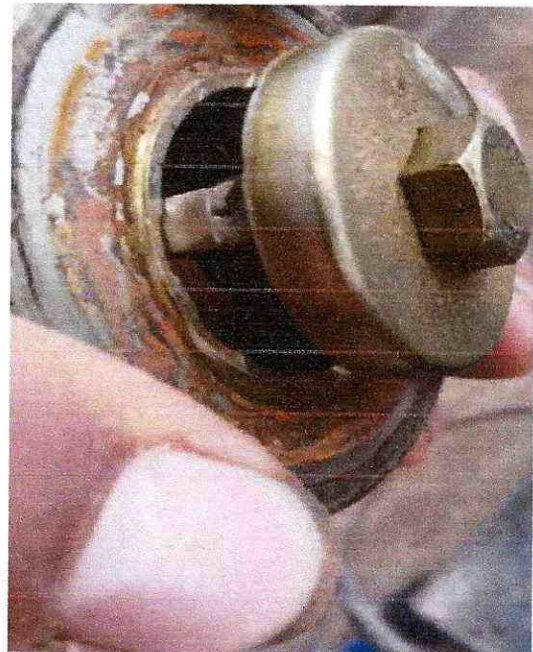
FIGURA 58. Válvula de retención de 2" erosionada con pérdida de material
