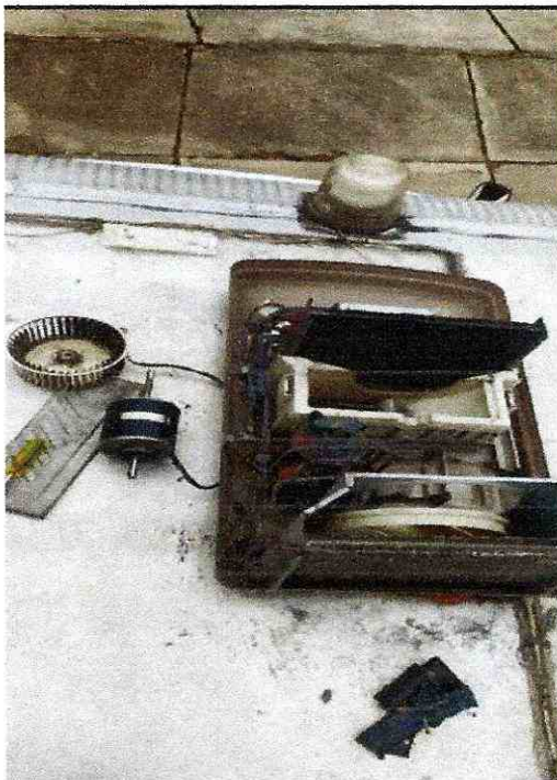
FIGURA 3. DESARME AIRE ACONDICIONADO
