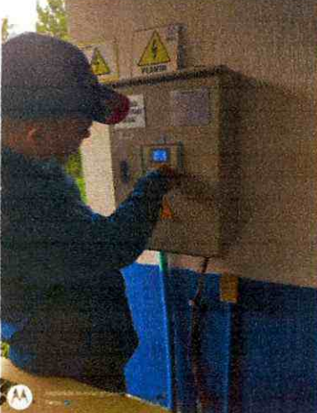
Mantenimiento planta electrica cay
