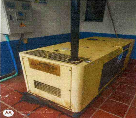
Mantenimiento planta electrica cay
