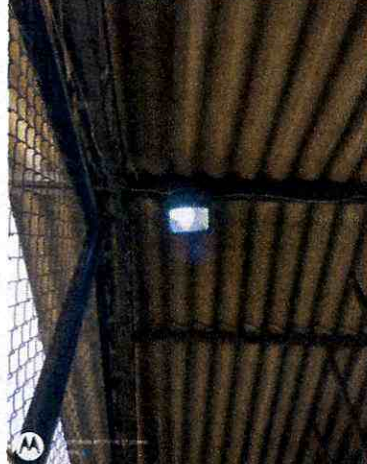
Cambio reflectores patio de gerencia
