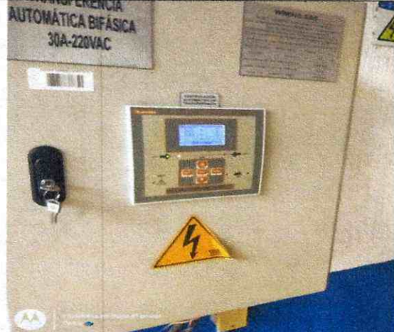
Mantenimiento planta electrica cay
