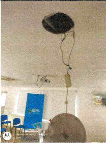
Instalación de internet salón del agua
