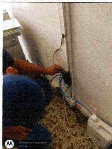
Instalación punto de red matriculas
