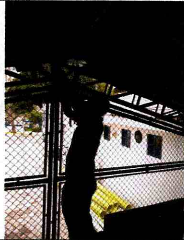
Cambio reflectores patio de gerencia
