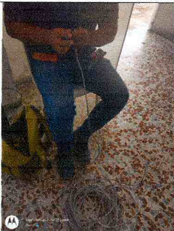
Instalación punto de red matriculas
