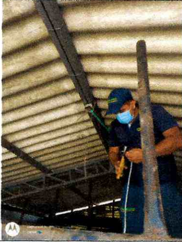
Cambio reflectores patio de gerencia
