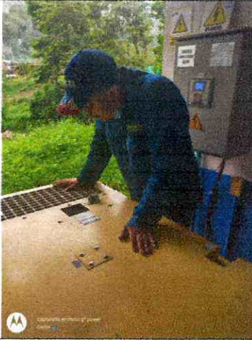
Mantenimiento planta electrica cay
