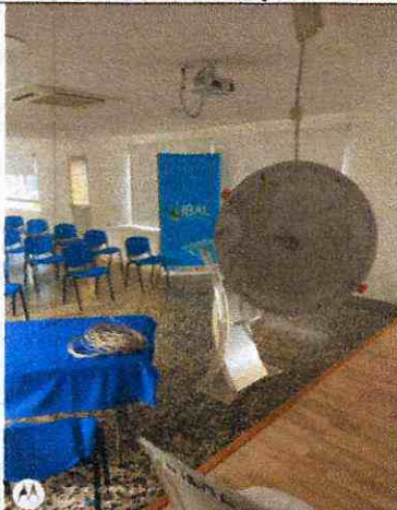
Instalación de internet salón del agua
