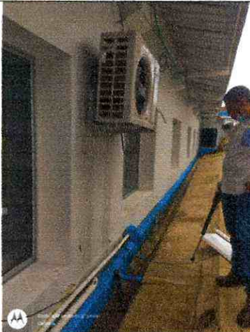
Mantenimiento aire sistemas
