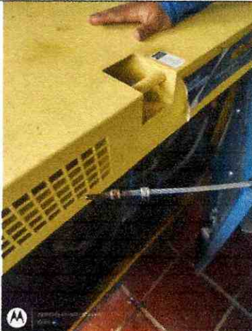
Mantenimiento planta electrica cay
