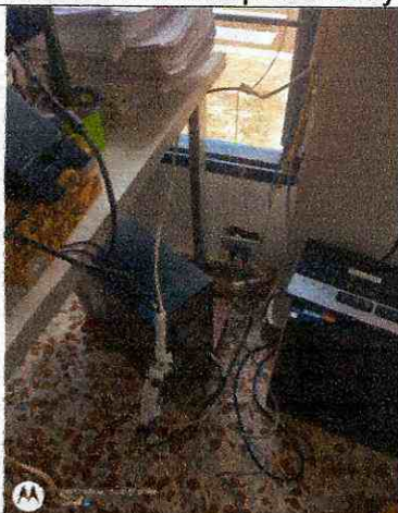
Instalación punto de red matriculas
