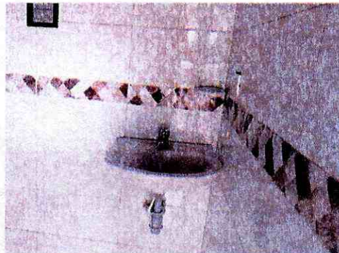
Foto 47. Área de lavado de manos. Consortio Redes Hidráulicas Ceiba Norte
