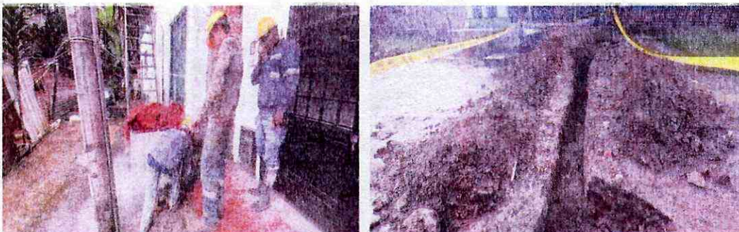
Corte y demolición de andenes para acometidas acueducto, excavación para acometidas acueducto.
