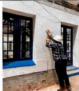
Figura No.6 señalización
