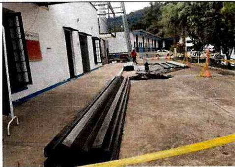
Figura No.5 señalización
