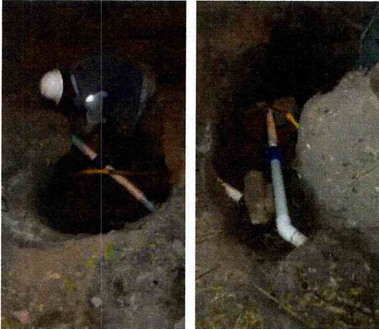
Empalmes calle 108 enseguida de la Rejilla existente.
