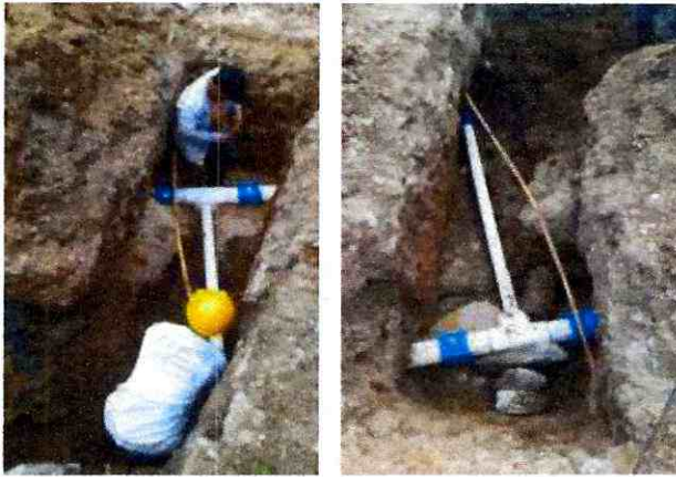
Empalme Cra. 1ª con Calle 33 la tubería de 3" viene de la Cra. 1
