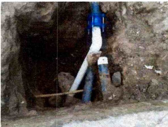
Empalme Cra. 1ª con Calle 33 la tubería va hacia la Cra. 2 por la peatonal
