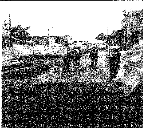
RUTURA DE PAVIMENTO
