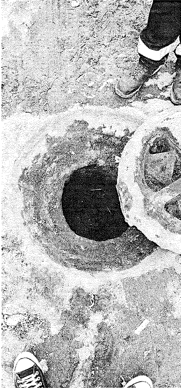
Calle 29 con carrera 4D (Válvula del pozo)
