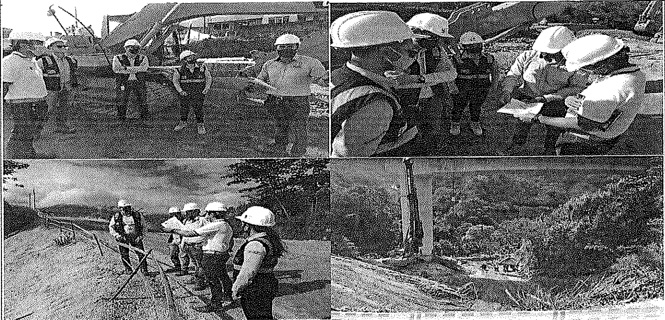
Fotografías 1, 2, 3 y 4: Sectores objeto de la solicitud para realizar la instalación de tubería de 36" en material GRP, con dos (2) cruces subterráneos por el método de perforación horizontal dirigida para el acueducto complementario en los K11+282 y K12+950, que pertenece al proyecto Segunda Calzada Ibagué - Cajamarca y Sistema Vial Existente Girardot - Ibagué - Cajamarca.
