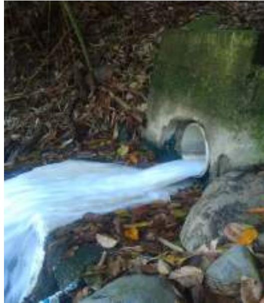
Fotografía 2 Salida PTARD Tejar
