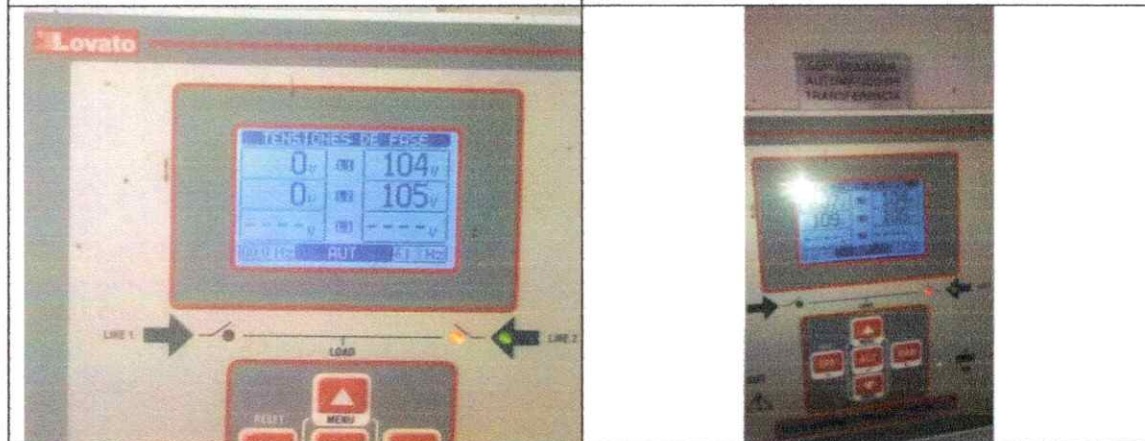
Revisión planta eléctrica bocatoma cay
