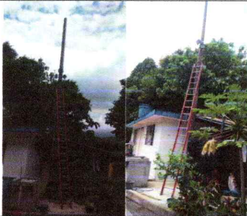
Cambio de iluminación planta el tejaz
