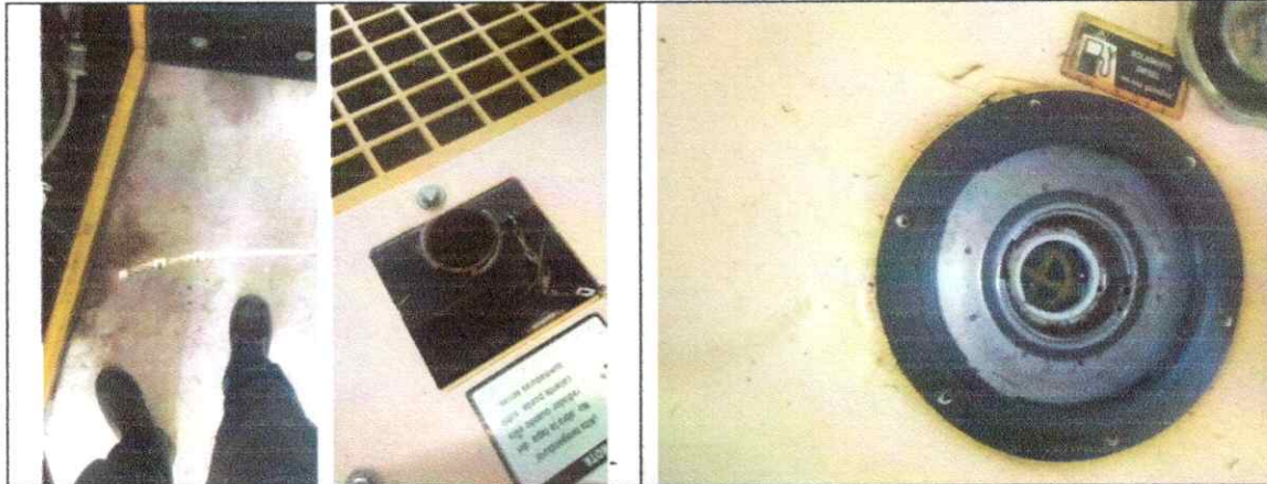
Revisión planta eléctrica planta bocatoma combeima
