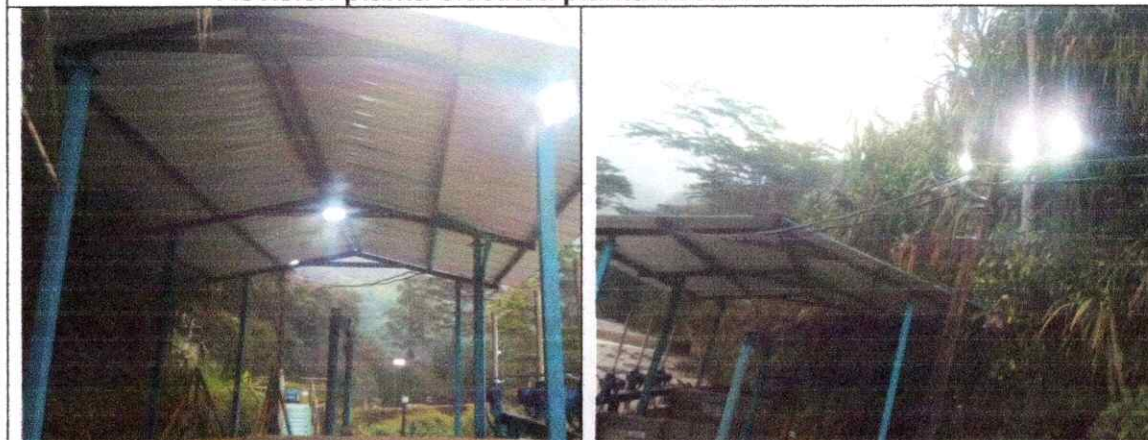
Revisión iluminación bocatoma combeima
