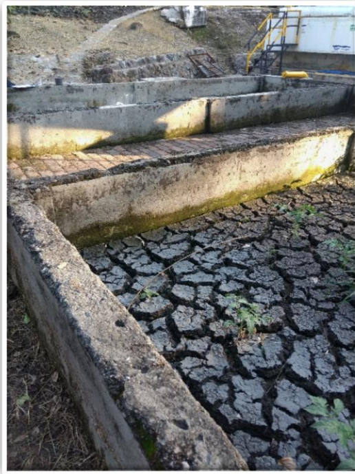
Foto N° 1. Lechos de Secado
