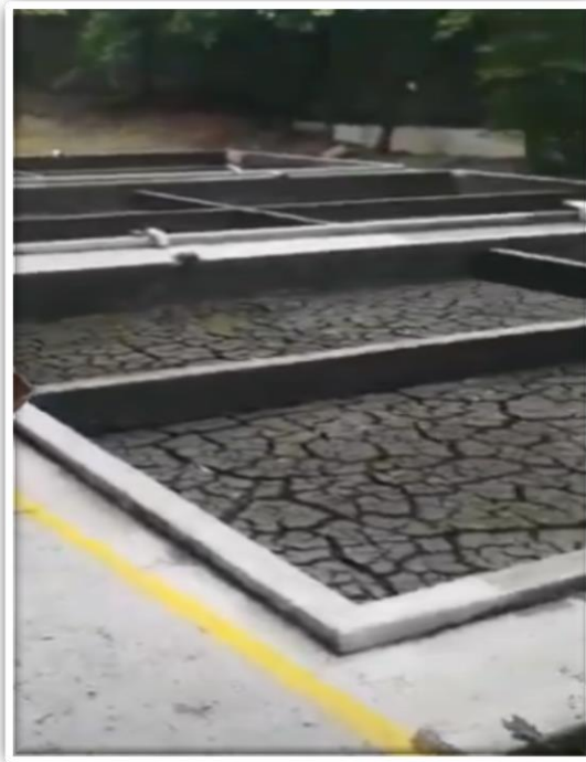
Foto N° 1. Lechos de Secado
