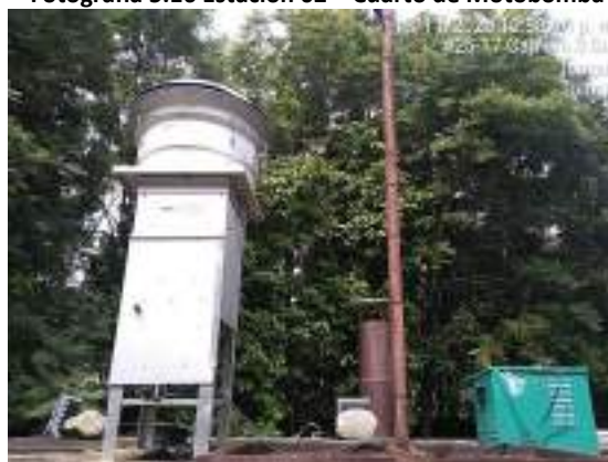
Fotografía 5.16 Estación 02 – Cuarto de Motobomba
