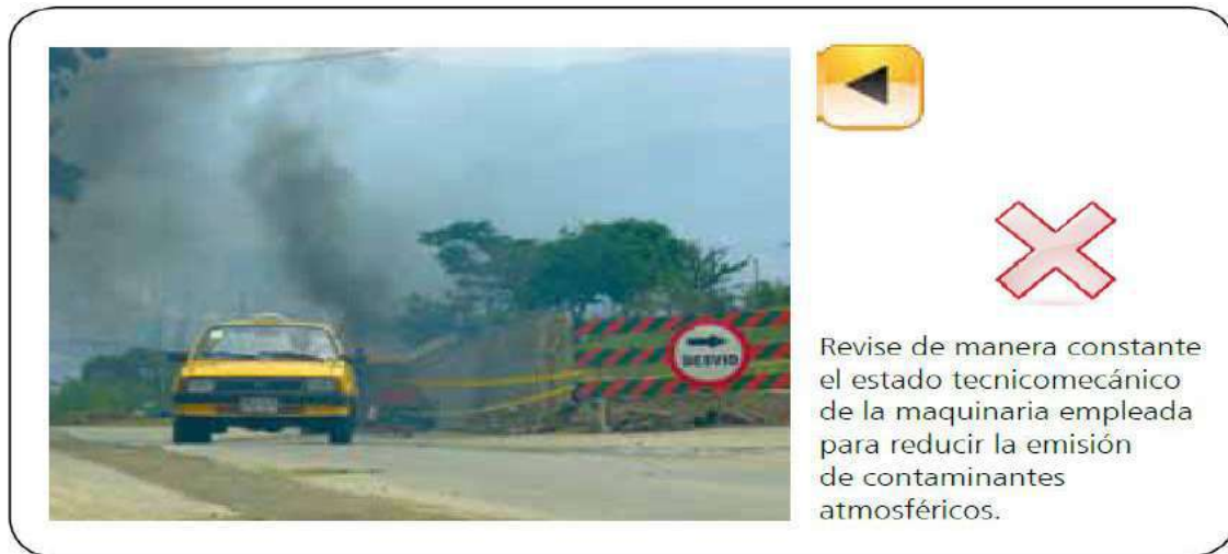
Figura 12. Mal manejo de partículas en el área de la obra
